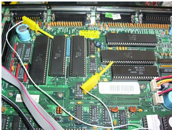
Widok prawidłowo podłączonych przewodów sygnałowych.
